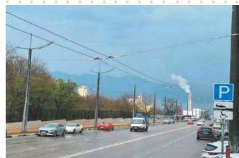
Контактная сеть троллейбуса на участке по ул.Южная от пр. Дзержинского до пр. Ленина
